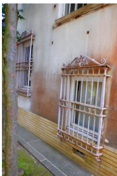
腐食、劣化した出格子
